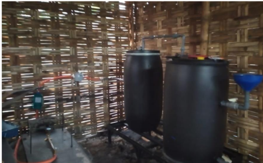
Gambar 5.4. Instalasi Biodigester Portable Yang Digunakan Untuk Membuat Biogas Dari Limbah Cair Tahu
