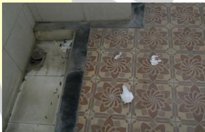
Gambar 8. Kondisi sampah kamar mandi yang berserakan di lantai tiga
